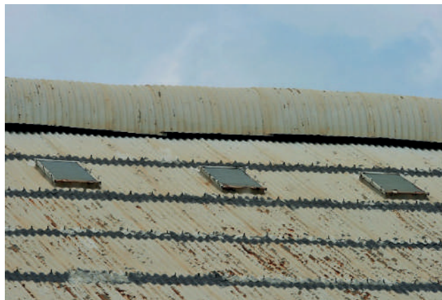
ภาพที่ 2 การผุกร่อนของหลังคาสังกะสีเมื่อทำปฏิกริยากับน้ำฝนที่มีสมบัติเป็นกรด
