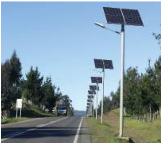
ค. เสาไฟถนน
