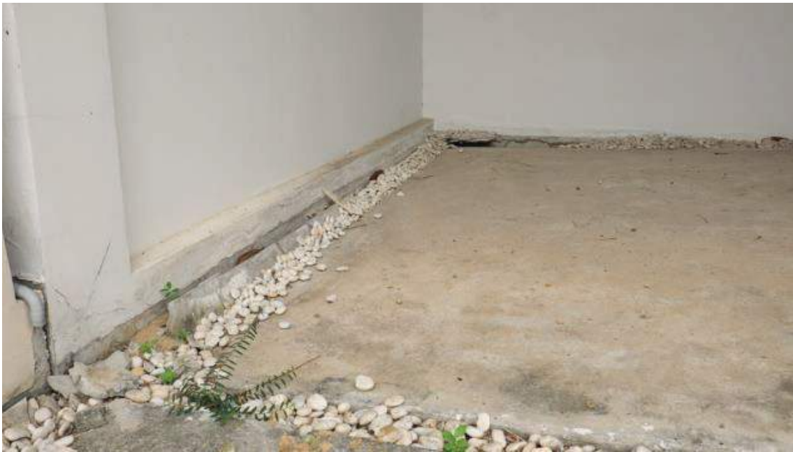
ภาพที่ 2 พื้นคอนกรีตทรุดตัวเนื่องจากแผ่นดินทรุด
