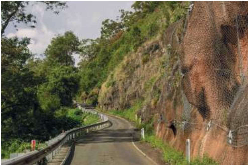
ภาพที่ 6 การติดตั้งตาข่ายกันดินและหินบริเวณที่ลาดเชิงเขา
