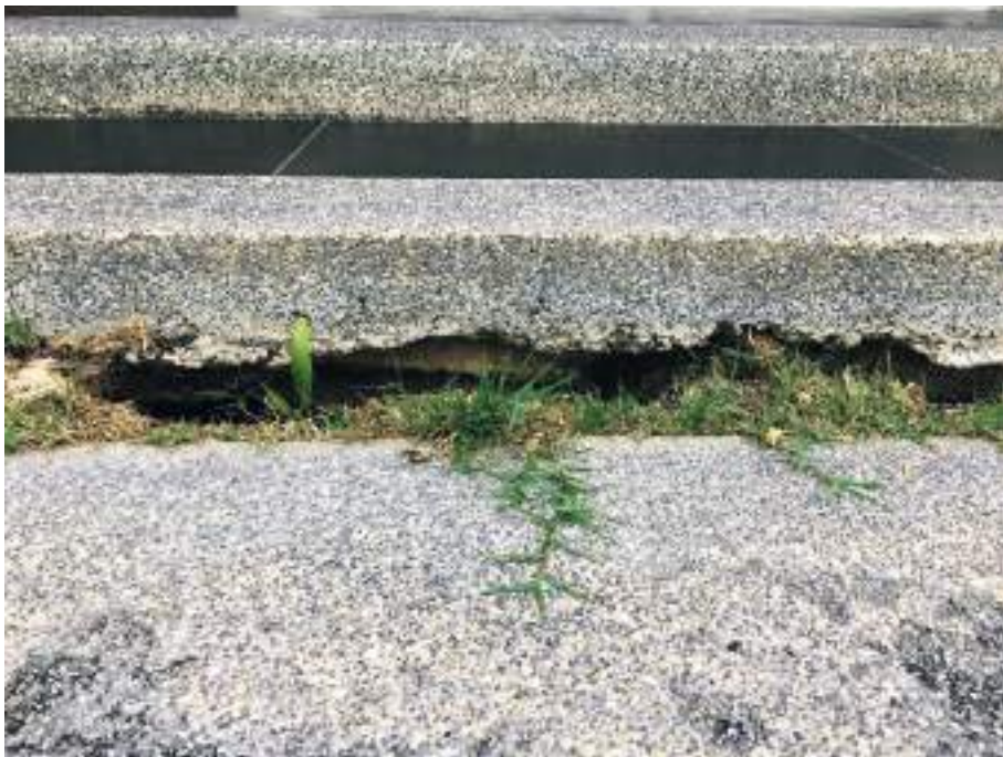
ข. พื้นอาคารทรุด แตกออกจากบันไดอาคาร
