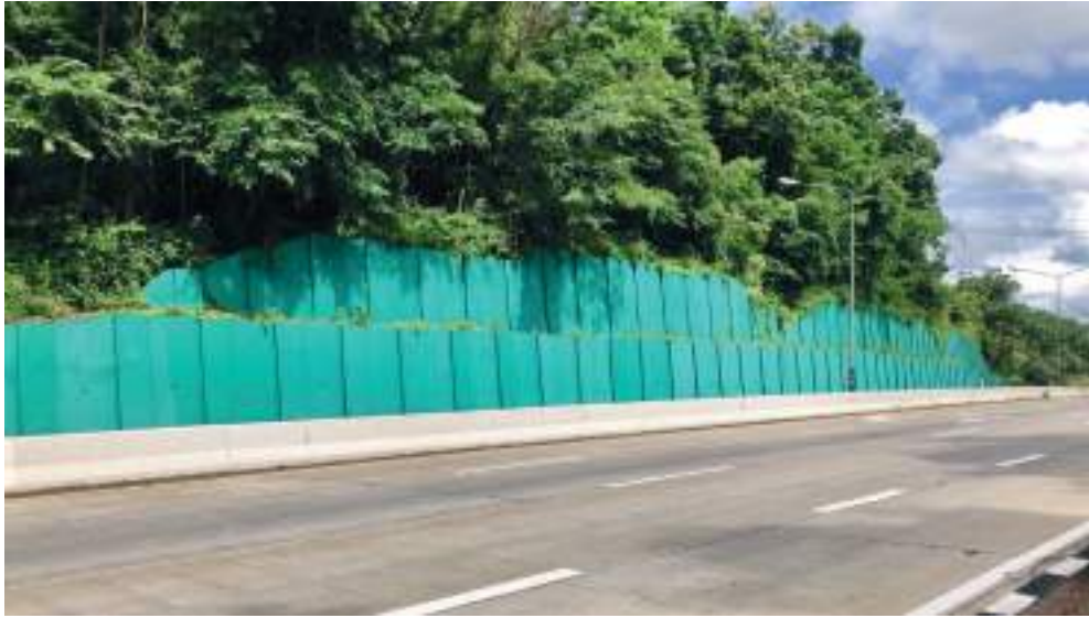
ภาพที่ 5 การทำกำแพงคอนกรีตป้องกันแผ่นดินถล่ม
