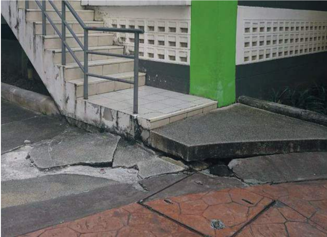
ภาพที่ 3 พื้นคอนกรีตทรุดตัวและแตกร้าวเนื่องจากแผ่นดินทรุด
