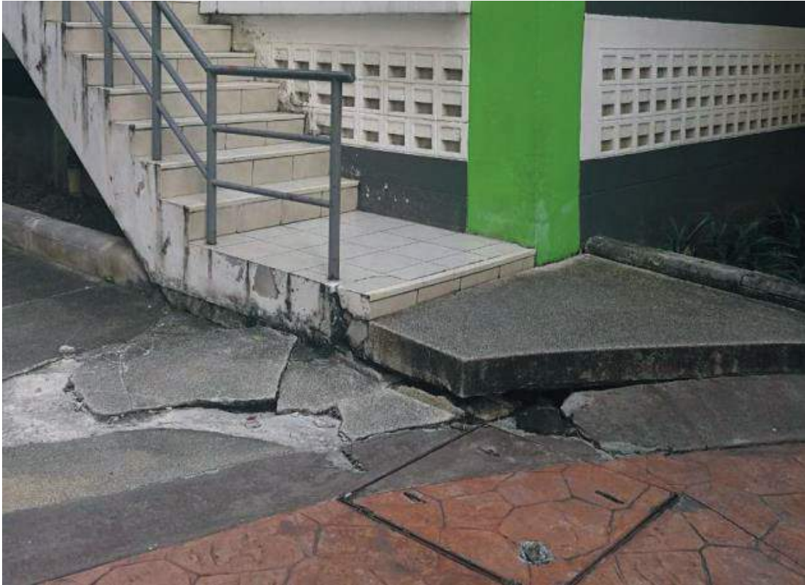
ภาพที่ 3 พื้นคอนกรีตทรุดตัวและแตกร้าวเนื่องจากแผ่นดินไหว
