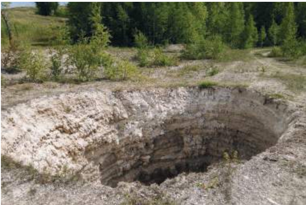
ข. หลุมยุบ บริเวณเหมืองหินปูน เส้นผ่านศูนย์กลางปากหลุมประมาณ 4.5 เมตร ลึกประมาณ 13-15 เมตร ภาพที่ 1 หลุมยุบ
