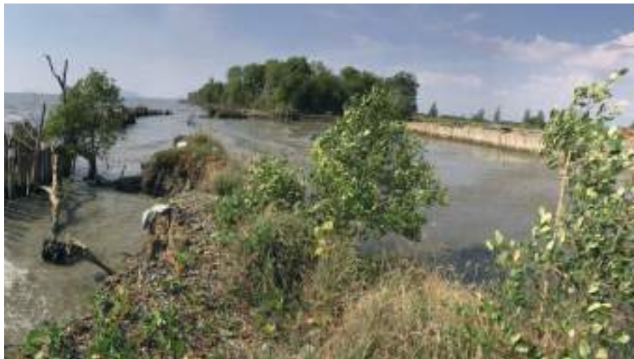
ภาพที่ 7 การกีดเซาะชายฝั่ง บริเวณบ้านเขาตาหน่วย ตำบลเกาะเปริด อำเภอแหลมสิงห์ จังหวัดจันทบุรี ที่มา : กรมทรัพยากรทางทะเลและชายฝั่ง
